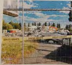
AMIANTE. Le périmètre est clos, car le chantier a débuté par un désamiantage de certaines parties du bâti. Photo: Corinne Garay
